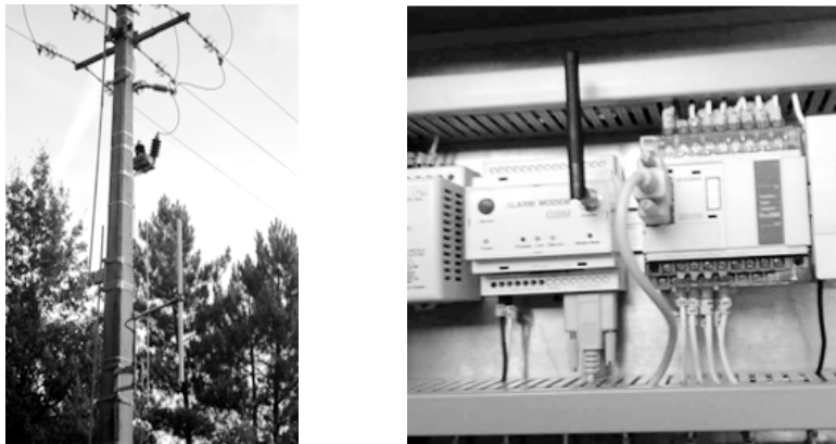
FIGURE 16 : antennes installées sur un poteau électrique et dans un armoire technique
